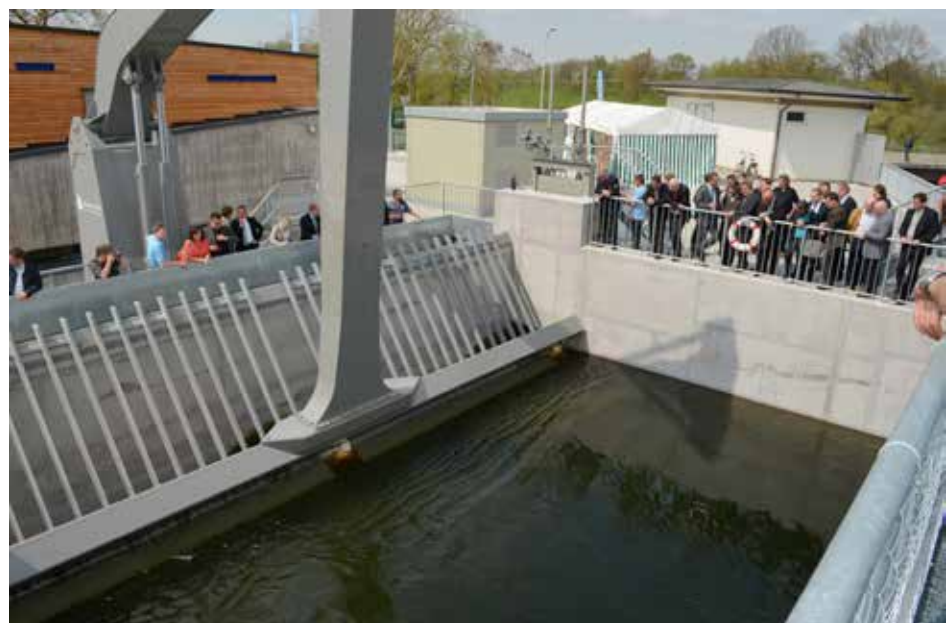
Abb. 7.7 Bild vom Rechen mit der Einrichtung (Rinne) zum Fischabstieg von der neuen Wasserkraftanlage in Willstätt an der Kinzig (Einweihung am 18.4.2013 u.a. durch den Baden- Württembergischen Umweltminister Franz Untersteller). Die neue Anlage ersetzt ein unüberwindbares Wehr und macht den Weg frei für den Lachs in die Kinzig.
