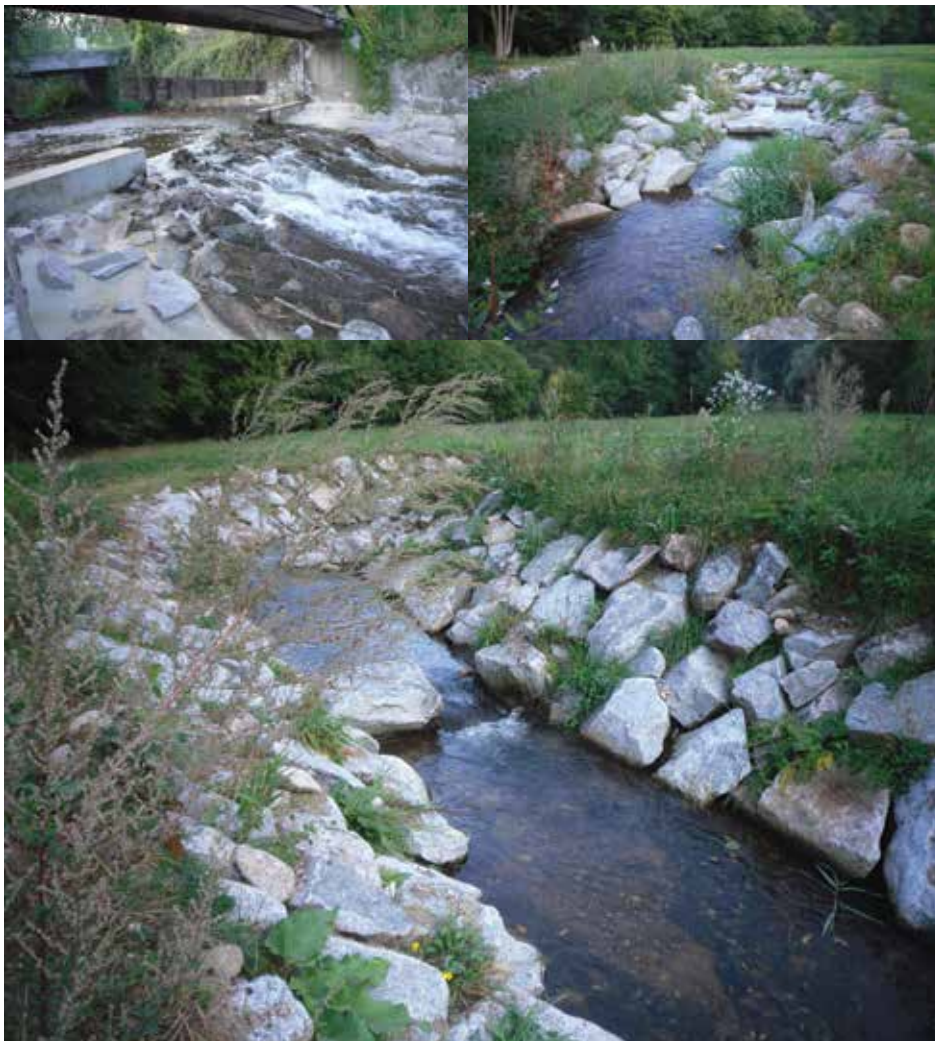
Abb. 7.1 Fischtreppe und Umgehungsgerinne an der Weiss einem Zufluss der Fecht. Die Fotos zeigen das Wehr mit geöffneter Klappe.
